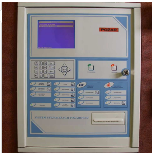
Obsługa panelu centrali sygnalizacji pożarowej
